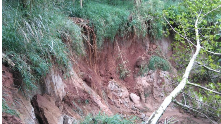
Figura 10 - Erosão no Bairro Marivan.
