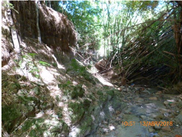
Figura 11 - Erosão no Córrego do Serrilhal.
